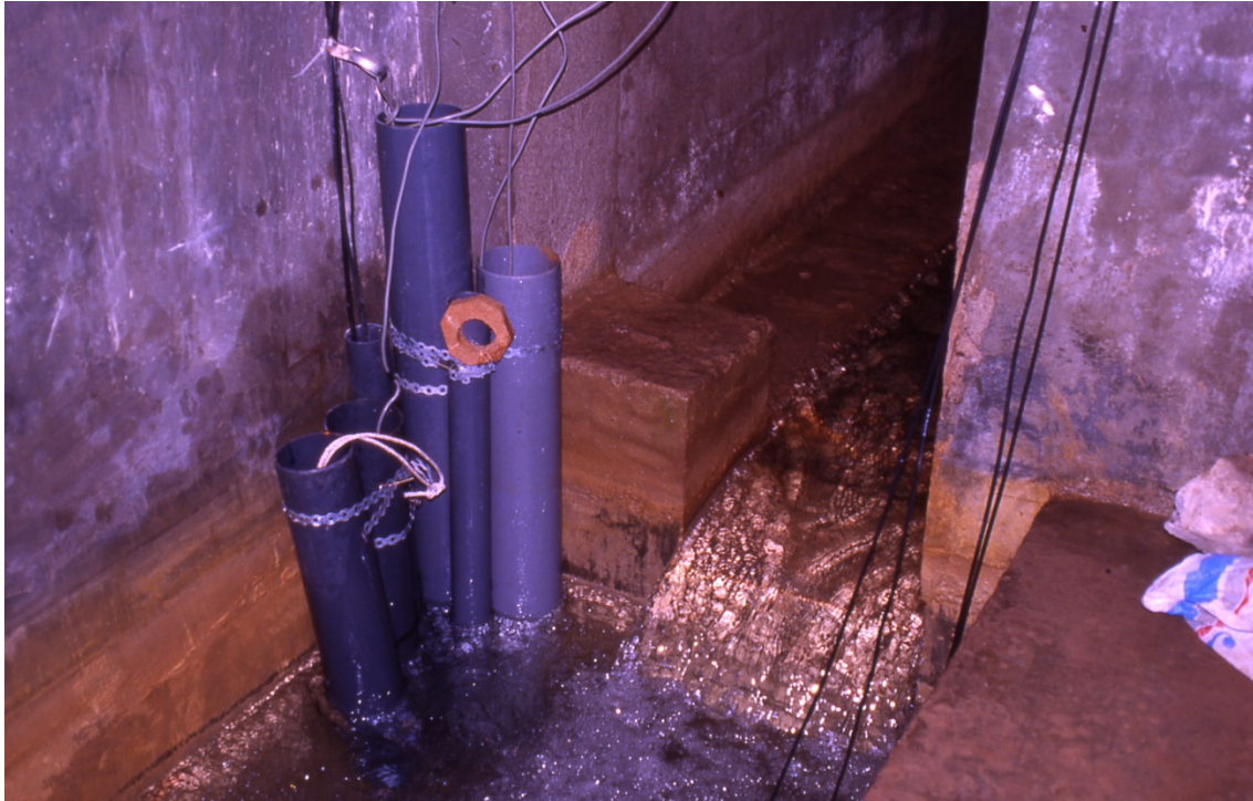
Figura 6. Captació de la font del Violí per a l'abastament d'aigua potable. Instruments del monitoratge: sondes de cabal, temperatura, conductivitat i radó.
